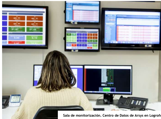
Sala de monitorización. Centro de Datos de Arsys en Logroño
